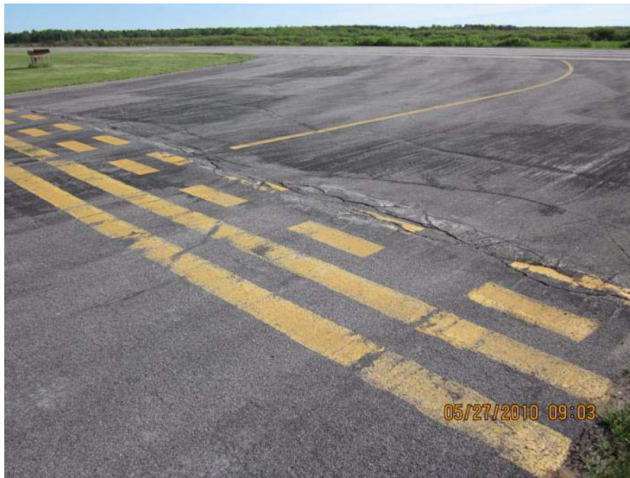
PWC PTA 003 (PCI = 26)
